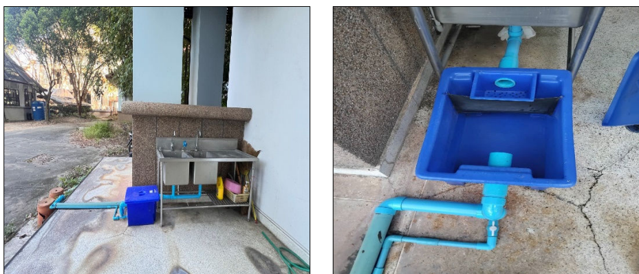
จุดติดตั้งถังดักไขมันบริเวณชั้น 1 (ด้านหลัง)
