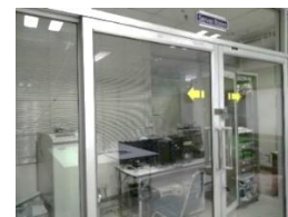
ห้องServer
