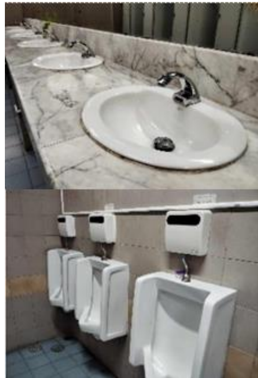
ติดตั้งระบบเซ็นเซอร์การเปิด-ปิดน้ำอัตโนมัติที่ก๊อกน้ำและโถปัสสาวะเพื่อประหยัดน้ำ
