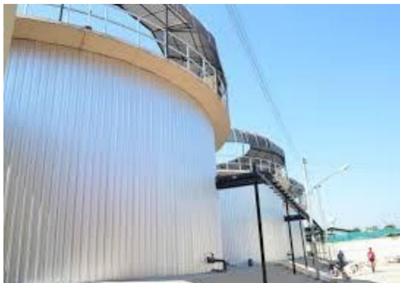
ภาพที่ 4.28 ระบบบำบัดน้ำเสียแบบเอสบีอาร์ (Sequencing Batch Reactor; SBR) มหาวิทยาลัยแม่โจ้
