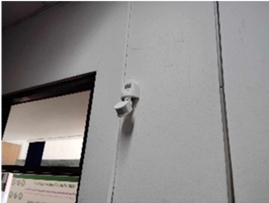
ติดตั้งเซนเซอร์เพื่อเปิด-ปิดหลอดไฟภายในห้องน้ำชาย และหญิง
