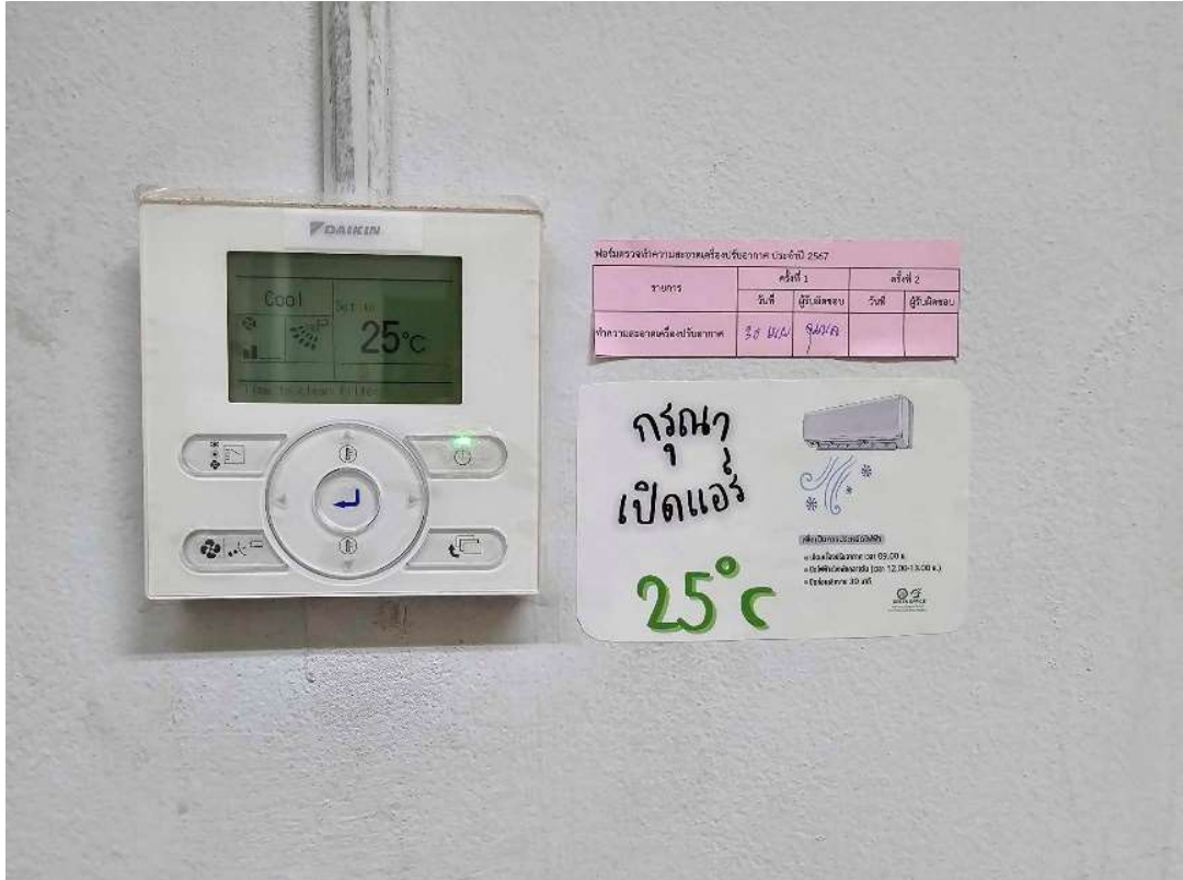
รูปแสดงปรับอุณหภูมิ 25 องศาของเครื่องปรับอากาศ
