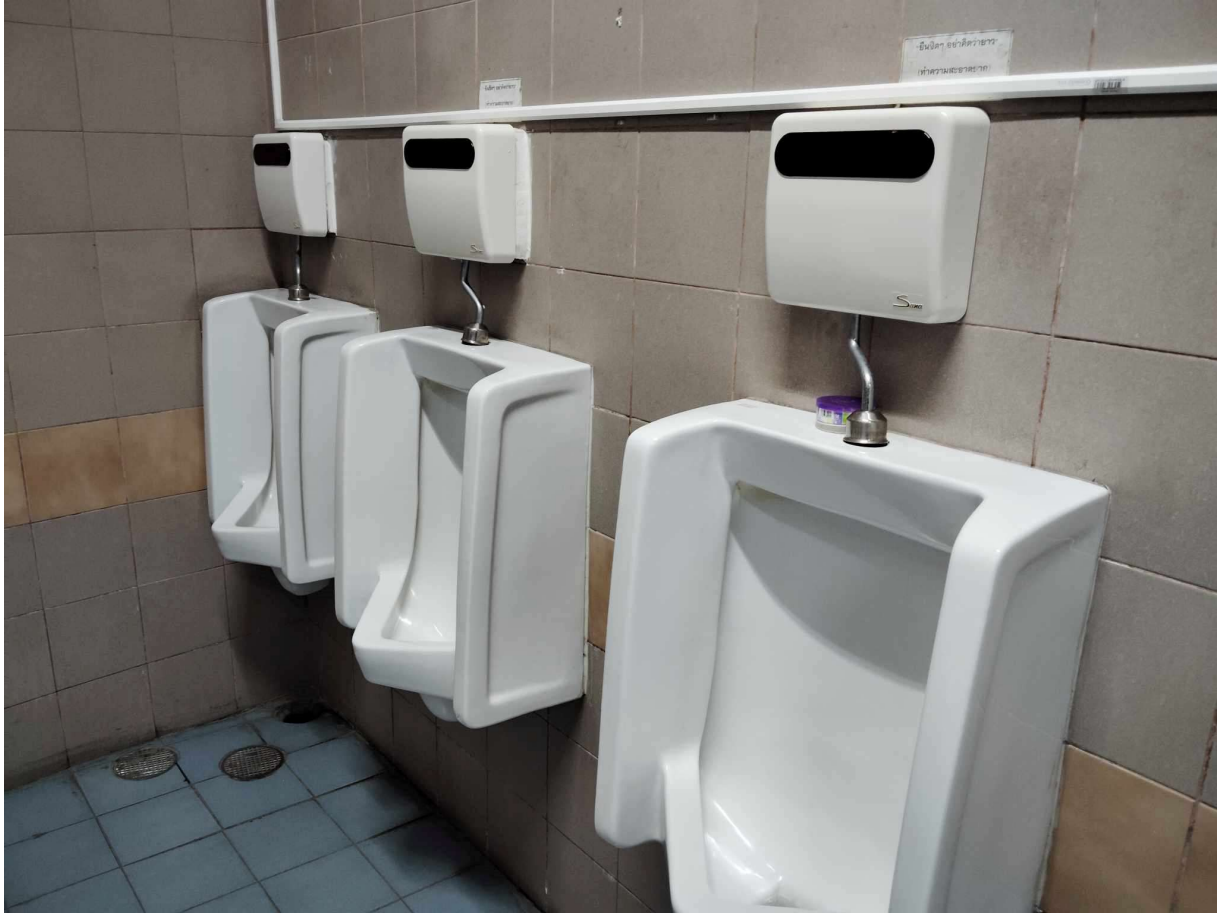
เปลี่ยนเป็นโถปัสสาวะ โดยใช้ระบบเซ็นเซอร์ (เปิด-ปิด) น้ำอัตโนมัติ (ประหยัดน้ำ)
