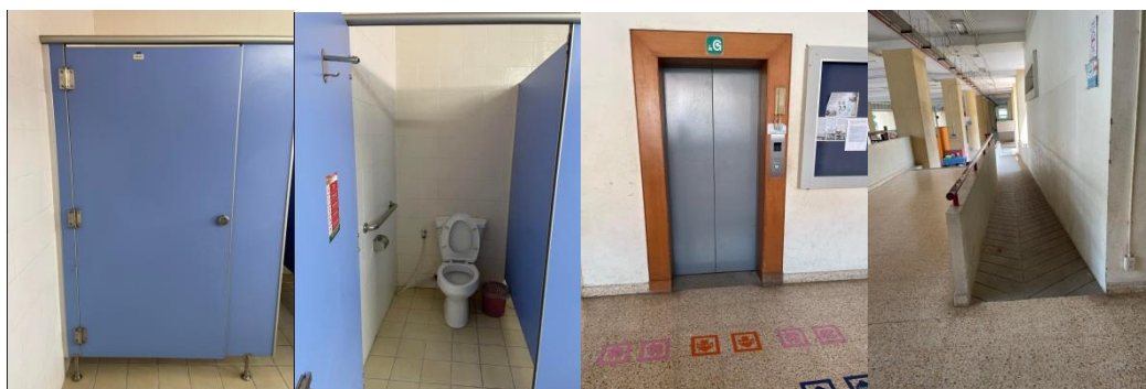
ภาพที่ 7.6.2 ห้องน้ำ ลิฟต์ ทางขึ้นอาคาร สำหรับผู้พิการหรือผู้บกพร่องทางร่างกาย อาคารจุฬาภรณ์
